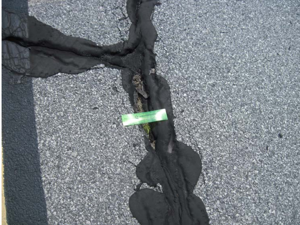
ANWRAMPAP-10. Block Cracking (Sample Unit #04).
